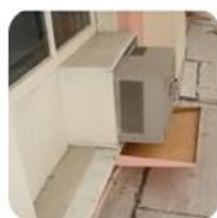
Bandejas de ar condicionado
