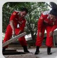
Caixas de passagem de água
